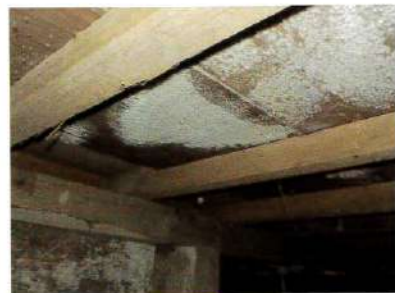
基礎断熱における結露由来のカビの事例。基礎コンクリートの余剰水の放散が原因とみられる
