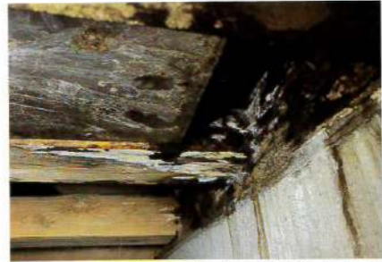
結露による普及に気づかず腐敗が進行した例。結露は放置しておくとも重篤化する
