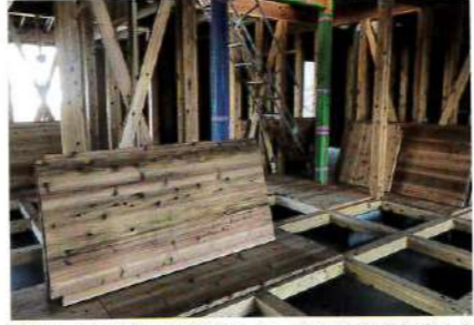
現場における乾燥促進の工夫。床下地の合板をすぐに張らずに仮置きとして通気を確保している
